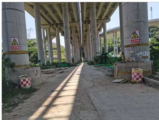
广河高速桥底施工便道现状
