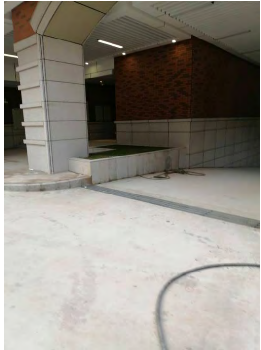
项目区内排水沟
