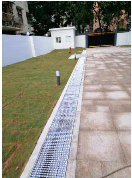
项目区内排水沟
