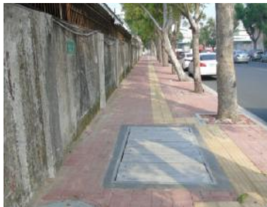
图 1-3 电缆沟监测点
