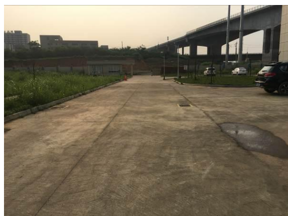
道路区硬化现状 2
