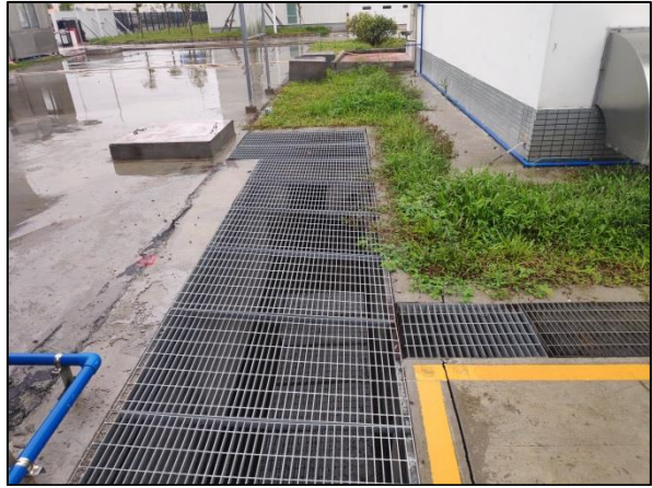
图 9 项目西侧出入口附近集水井现状
