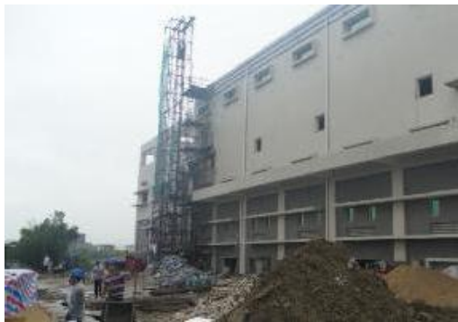
图 2-1 变电站南侧情况
