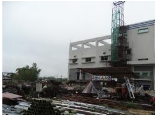
图 2 变电站 2017 年第 3 季度情况
