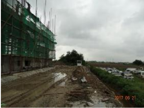
图 1 变电站 2017 年第 2 季度情况
