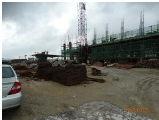
图 1-1 变电站南侧情况
