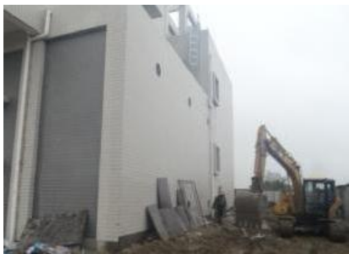
图 2-3 变电站东侧情况
