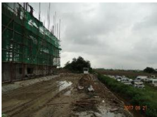
图 1-3 变电站东侧情况
