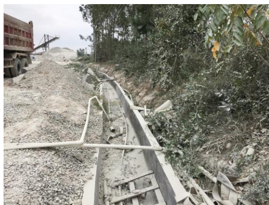
图 4：工业场地排水沟现状 1
