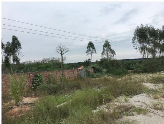
图 8:砖砌挡墙现状
