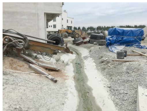
图 6：生活区排水沟现状
